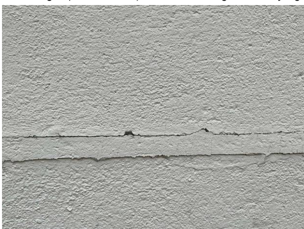
Bild 3: Utvändigt, Fasad, Fog i elementskarvar har släppt
