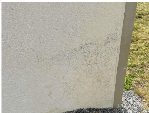
Bild 2: Utvändigt, Fasad, Färgsläpp finns på fasaden
